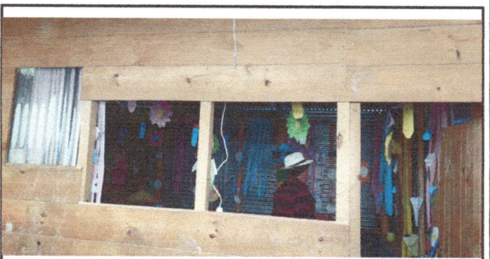
Foto 6: Sustrucción de Valcones
